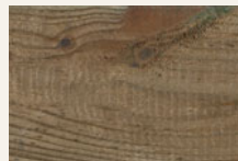
Rauhe Stellen auf der Holzoberfläche
