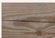
Spannungsrisse durch die Holz Trocknung
